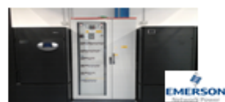
CRAC e QCEE di sala
